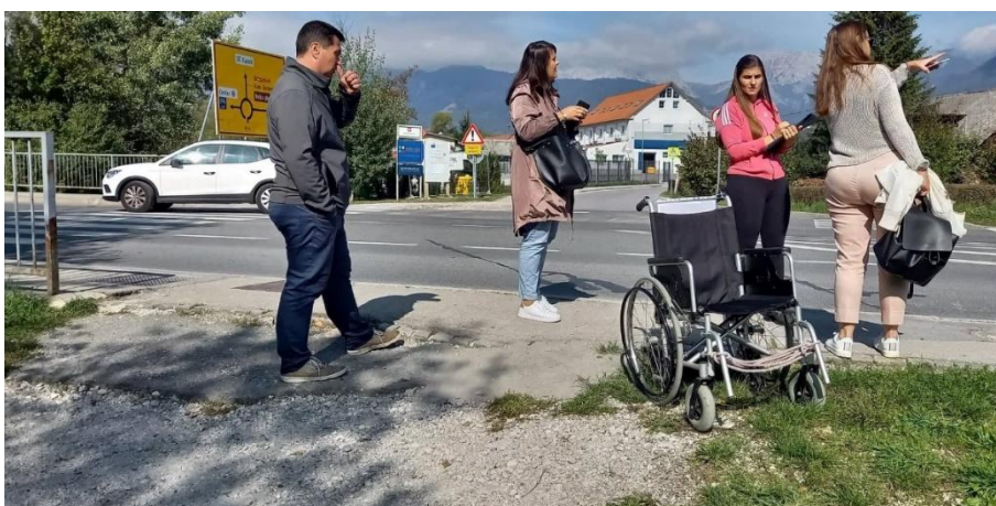
Slika: Za gibalno ovirane in invalidske vozičke neprimerno urejen dostop s pločnika v park – naklon klančine, dotrajan, razpokan asfalt, pesek na asfaltu (foto arhiv projekta).
